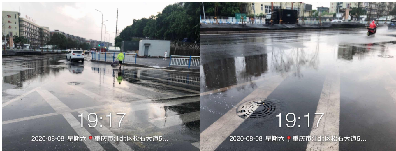
图 8-3 松石路高石坎路口段积水点现场照片
