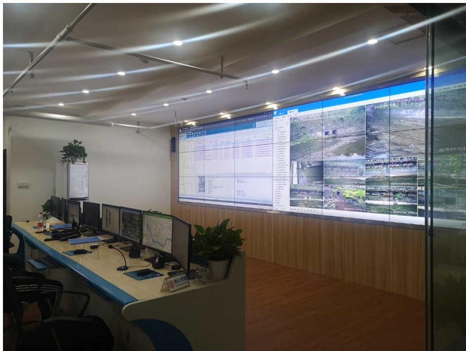
图 9-7 智慧排水平台控制中心
